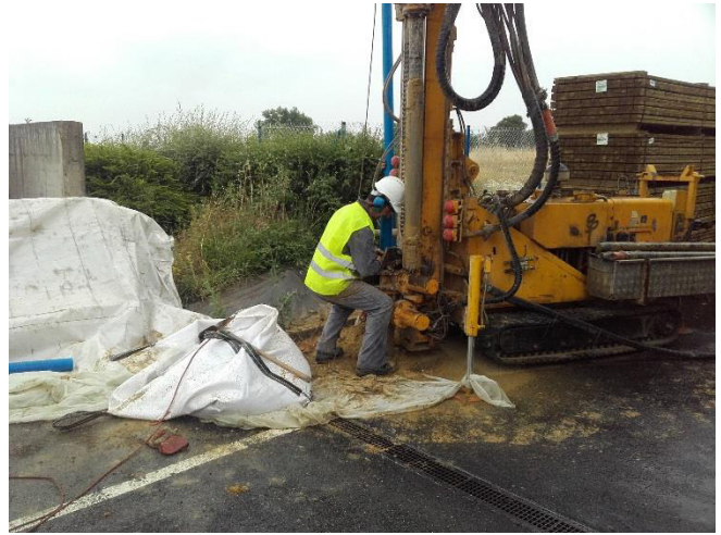
Equipement du piézomètre Pz3
